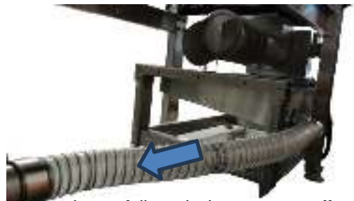
Abb. 5.1.10. Höhengefälle zwischen Pressenöffnung und Klärbehälteröffnung
